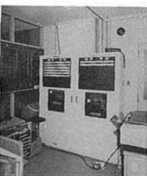
自動火災報知受電盤 自動防煙排煙装置
