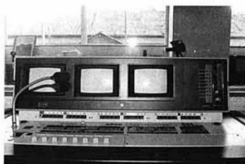
▲設備の整った放送室
