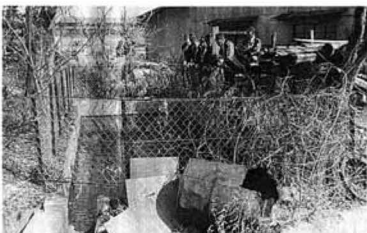
▲防火水槽の漏水箇所を視察
