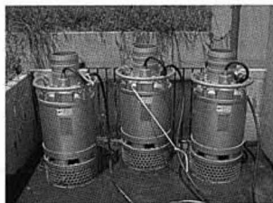
設置された3台の水中ポンプ
