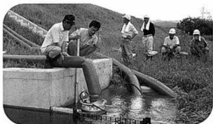
水中ポンプによりホースで、内水を滝川へとかき揚げます
