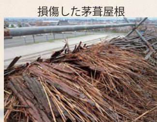
損傷した茅葺屋根
