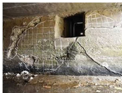
90. 3070-1号橋：RC床版橋、 ボックスカルバート (橋長：2.30m、1986年竣工) A2橋台のひびわれ、うき、欠損 (ひびわれ幅：9.0mm) ※多数のひびわれの発生により、鉛直支持機能の低下が推測される。(迂回路有)
