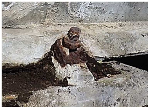
中ノ目橋：支承の腐食、変形
