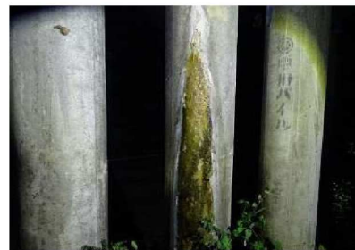
山ノ神前橋：橋脚の錆汁を伴ったびびわれ
