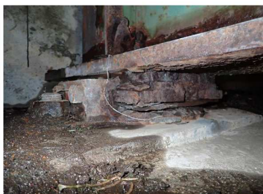
大木戸橋：支承の腐食
