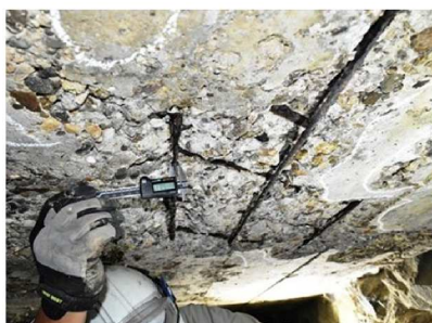
79. 2168-2号橋：RC床版橋 (橋長：2.50m、1988年竣工) 床版下面の鉄筋露出・断面欠損 ※露出鉄筋の腐食の進行は、耐荷力の低下に影響する。(迂回路有)
