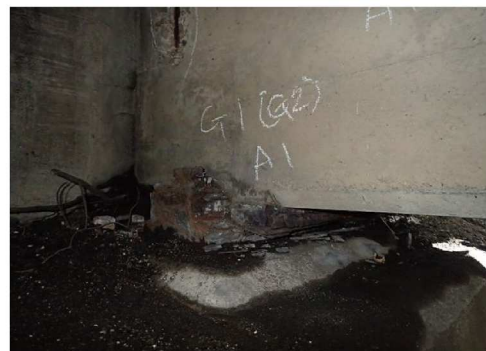
瀧川橋：支承の腐食
