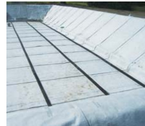
③更に保護マットを敷設し、集水管を設置し、その後保護土を敷きならす
