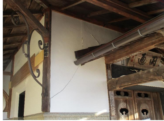
町登録「福源寺地藏庵観音堂」外壁漆喰亀裂
