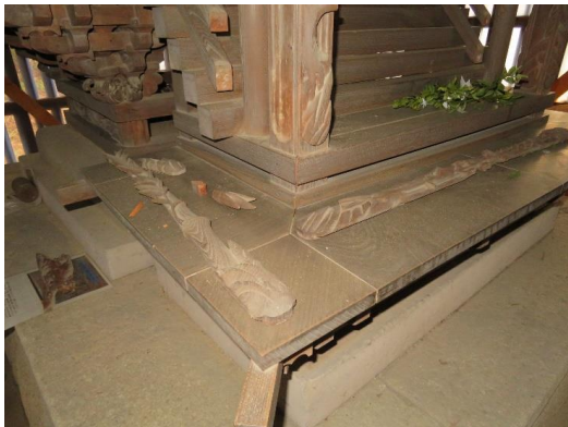
町登録「沼田神社本殿彫刻一棟」彫刻の破損、ずれ
