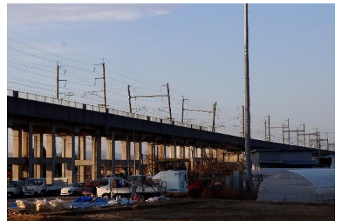
■新幹線高架橋・架線の被害
