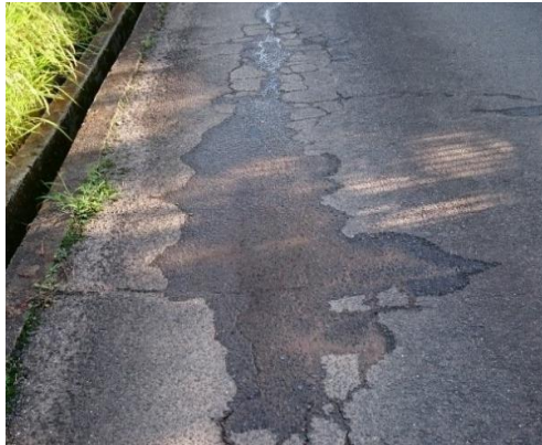
漏水発生状況
