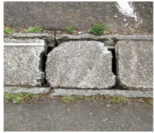
側溝蓋のガタツキ
