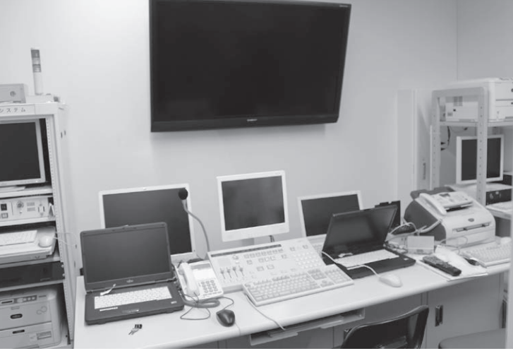
令和5年度に更新を予定している防災無線基地局
