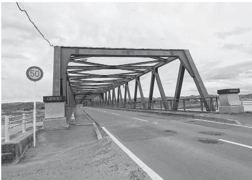
徳江大橋・町道4号(広域農道)の現状
