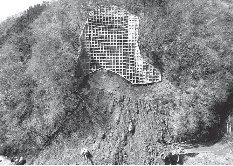
大規模な土砂崩れがあった林道貝田線法面復旧工事
